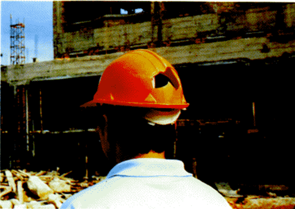
หมวกใบนี้ คนงานที่เคยใส่ ถูกท่อนแป๊บเหล็กตกใส่ ปรากฏว่าคนงานปลอดภัย
