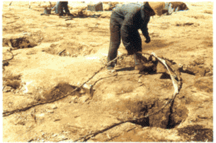
ลวดสลิงที่ครบอายุใช้งาน หรือชำรุดลวดขาดไปบ้าง ก็ควรพิจารณาเปลี่ยนใหม่ ไม่ใช่ผืนใช้กันในลักษณะนี้ ซึ่งนับว่าอันตรายมาก
