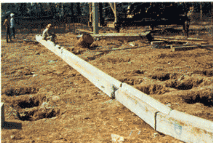
เสาเข็มต้นที่หักอยู่นี้เกิดจากลวดสลิงขาด เคราะห์ดีที่ทุกคนหลบกันทัน
