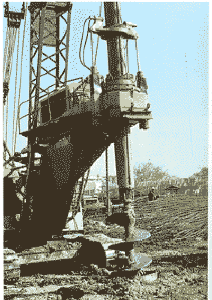
การทำเสาเข็มเจาะจะทำให้เกิดรูเจาะขนาดใหญ่ทั่วบริเวณ
