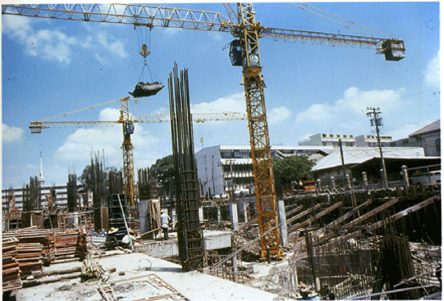
หอบันจั่น (Tower Crane)
