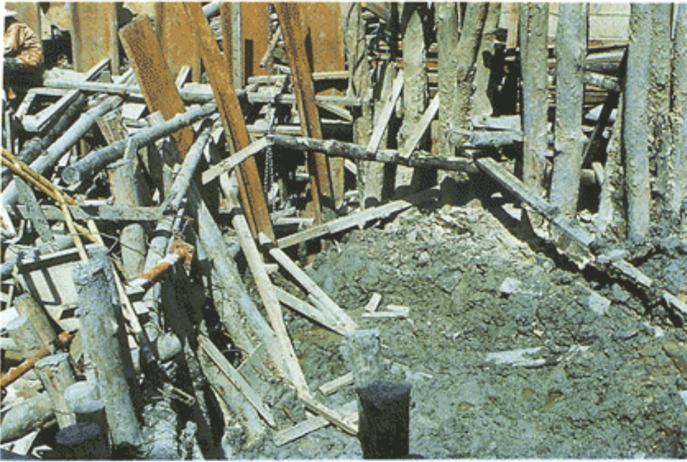
การขุดดิน โดยไม่ป้องกันให้เพียงพอ อาจทำให้เกิดการวิบัติได้
