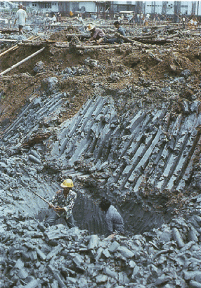
การขุดดินลึกเช่นนี้โดยไม่มีการป้องกัน ดินอาจพังมากจนคนงานถึงตายได้
