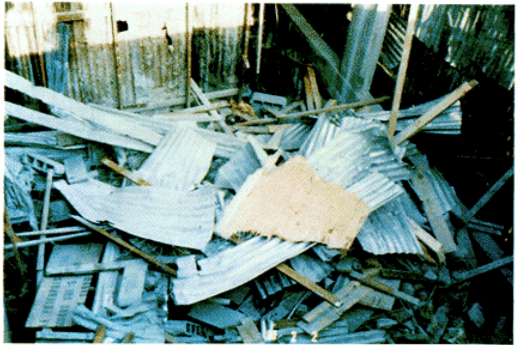
ขณะแตกคอนกรีต หน้าหนักของคอนกรีตถูกถ่ายลงบนหลังคาสังกะสีนั้น ทำให้พื้นสำเร็จรูปพังลงมาทับคนงานที่นอนอยู่ใต้นั้นถึงแก่ความตายถึง 4 คน
