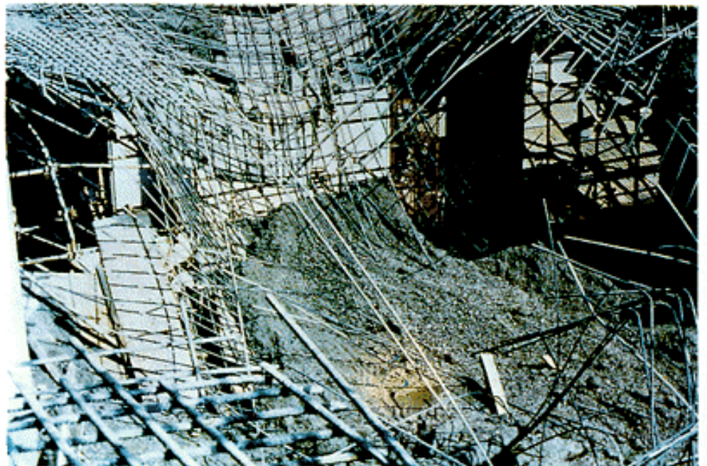
การใช้ค้ำยันที่ไม่แข็งแรงพอ อาจเกิดการวิบัติเช่นนี้ได้
