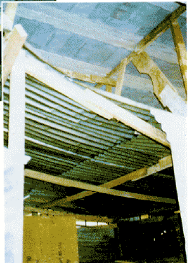
โดยเฉพาะเมื่อสังกะสีมีเพียงไม้เล็ก ๆ 2 ชั้นรองรับ และชั้นบนยังไม่ได้เท Concrete Topping
